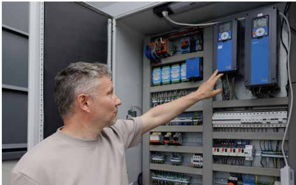
Exoconin toimitusjohtaja Jarmo Lehto tarkastelee lämpöpumpun taajuusmuuttajaa. Taajuusmuuttajien avulla automaatio sovittaa kompressorin toimintaa kulloiseenkin tarpeeseen, mikä parantaa järjestelmän energiatehokkuutta.
