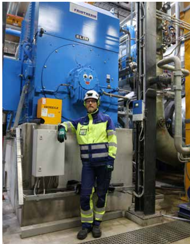
60 megawatin lämpöpumppulaitoksen kolme valtavaa sinistä pumppua siirtävät lämpöä jätevedenpuhdistamon poistovedestä kaukolämpöjärjestelmään.
