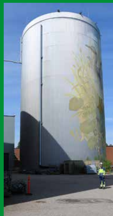
800 megawatin eli 200 000 kuutiometrin lämpöakkuun tankataan lämpöä matalan sähkön hinnan aikana. Lämpöä puretaan, kun sähkön hinta nousee.
