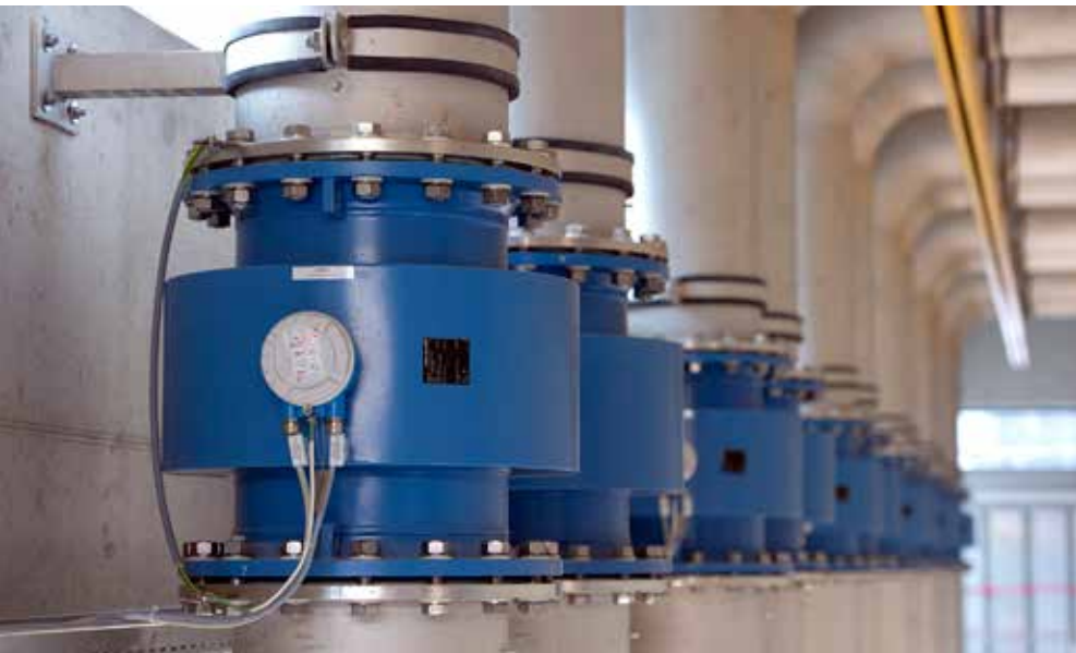
Magneettisia virtausmittareita jätevesilaitoksessa.
